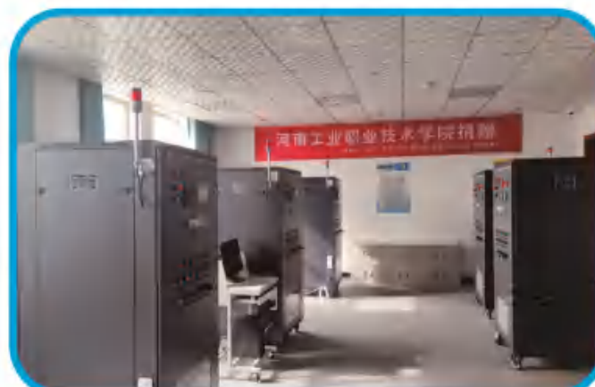
电器安装与调试实训室
